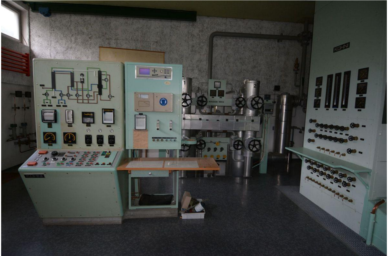
So ähnlich sah es auch in der Anlage in Madetswil aus: Blick in die einzige noch erhaltene militärische Sauerstoff-Fabrik in Ilanz GR. Foto: sauerstoff-fabrik.ch
